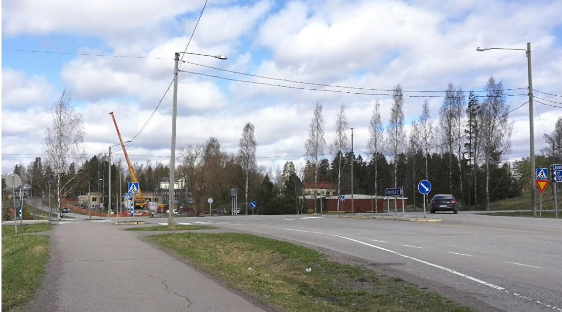
Kuva 3. Tiiläantie x Askolantien eteläpuolen liittymän suojatienäkymä. Saarekkeesta puuttuu suojatiemerkit ja olemassa olevista suojatiemerkeistä puuttuu herätevarret. Jalankulku- ja pyörävälillä näkyy lieviä pitkittäis- ja poikittaishalkeamia päällysteessä (toimenpide 5.).
